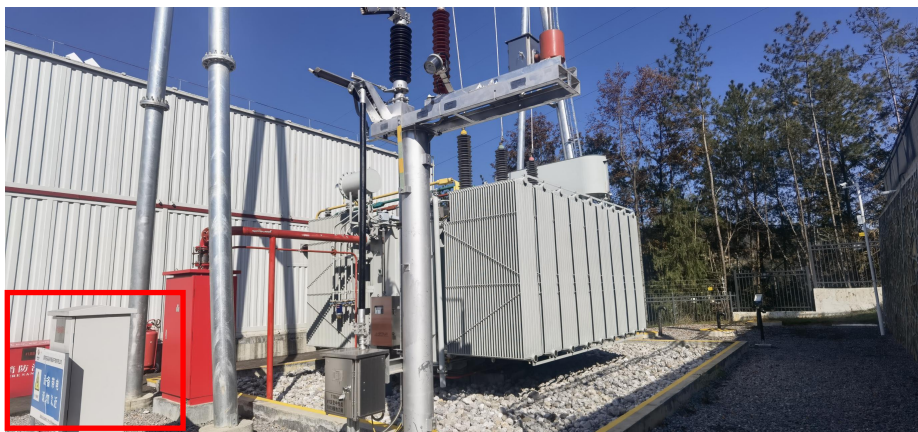
图 9-1 变压器旁设置了防火标志及灭火器
