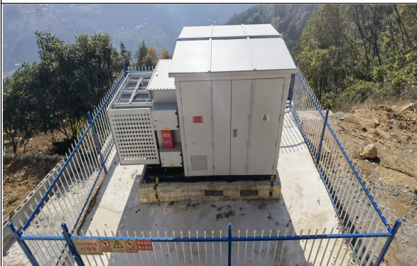
光伏阵列区内箱变
